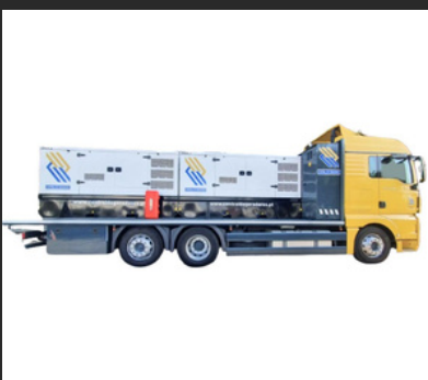
GERADORES EM SINCRONISMO 2X150 KVAS
